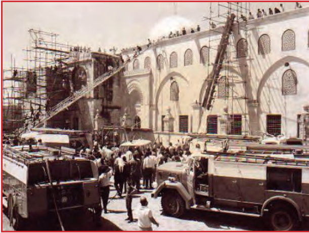
شكل (١٣٦) حريق المسجد الأقصى عام ١٣٨٩هـ/١٩٦٩م
